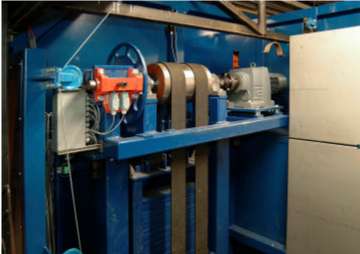
Antriebsstation mit Getriebemotor, Kupplung, Antriebstrommel und Verriegelung
